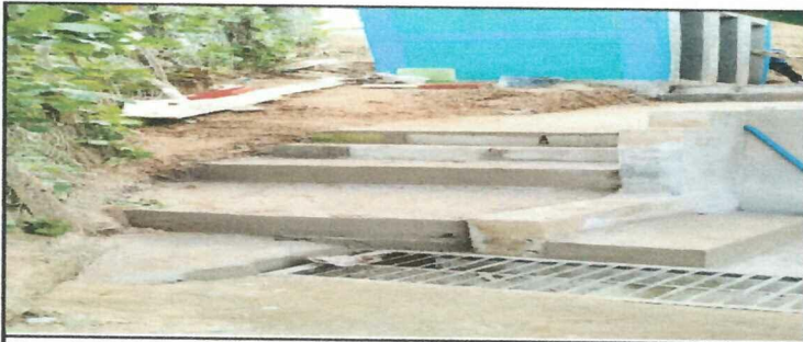
Foto 3: TORTA DE CEMENTO COLUMNAS PARA CONTENCIÓN DE MURO, GRADAS PARA EL PASO YA QUE CUANDO LLUEVE LOS ALUMNOS INGRESAN CON MUCHO LODO A LAS
