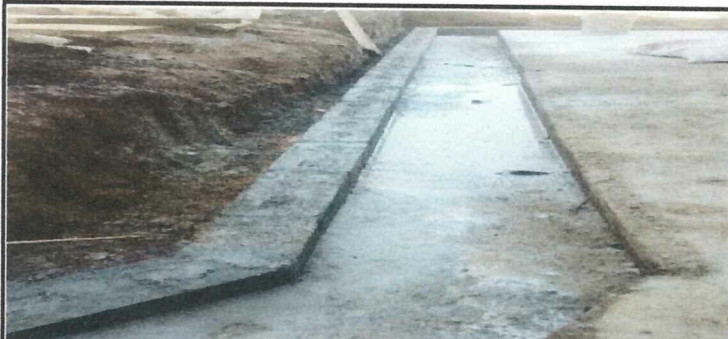
Foto 1: CUNETA DE CONCRETO YA QUE CORRE MUCHA AGUA POR EL AREA Y SE SALE DEL CANAL DE CONCRETO
