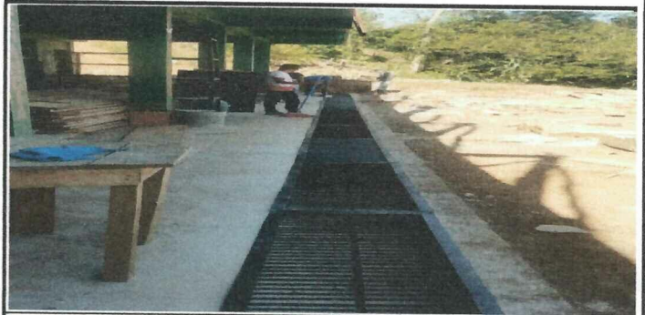
Foto 2: REJILLAS DE METAL COLOCADA
